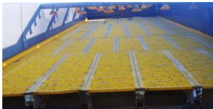
Ett siktdäck med PU-siktduk av modultyp samt spraydysor.
